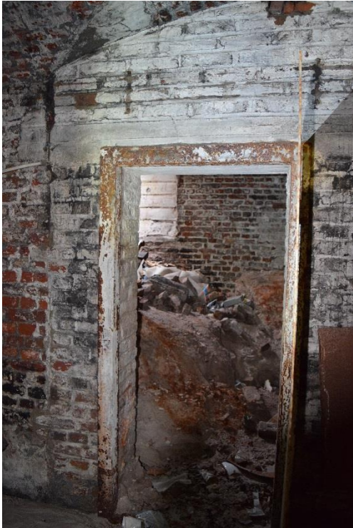
Puin in een van de kelders van de Belgen
